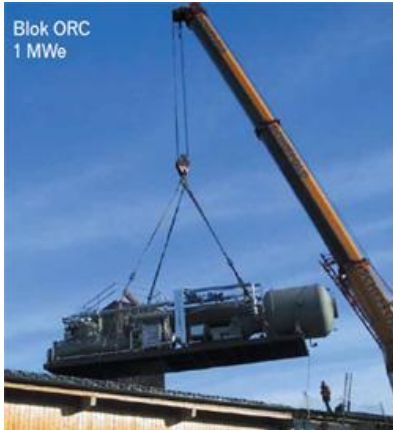
Rys. nr 17 Elektrociepłownia ORC, moduł ORC
